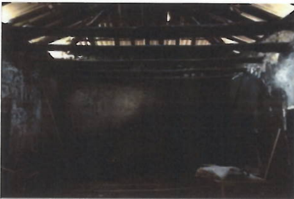
Habitación central en planta alta, se evidencia incendio ocurrido
